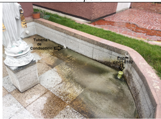
Foto No. 4. Estado alrededor de la boca del pozo
