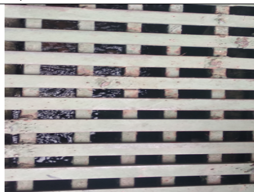
Foto No. 6. Red interna de alcantarillado de aguas lluvias.
